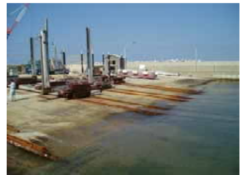
省エネにつながる船底整備のための 漁船巻揚施設
