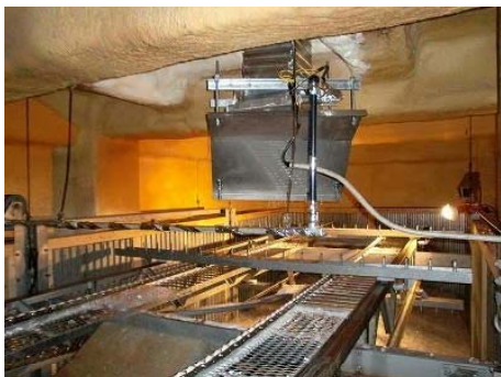
製氷施設 (福岡市漁協西浦支所)
