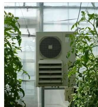
ヒートポンプ
